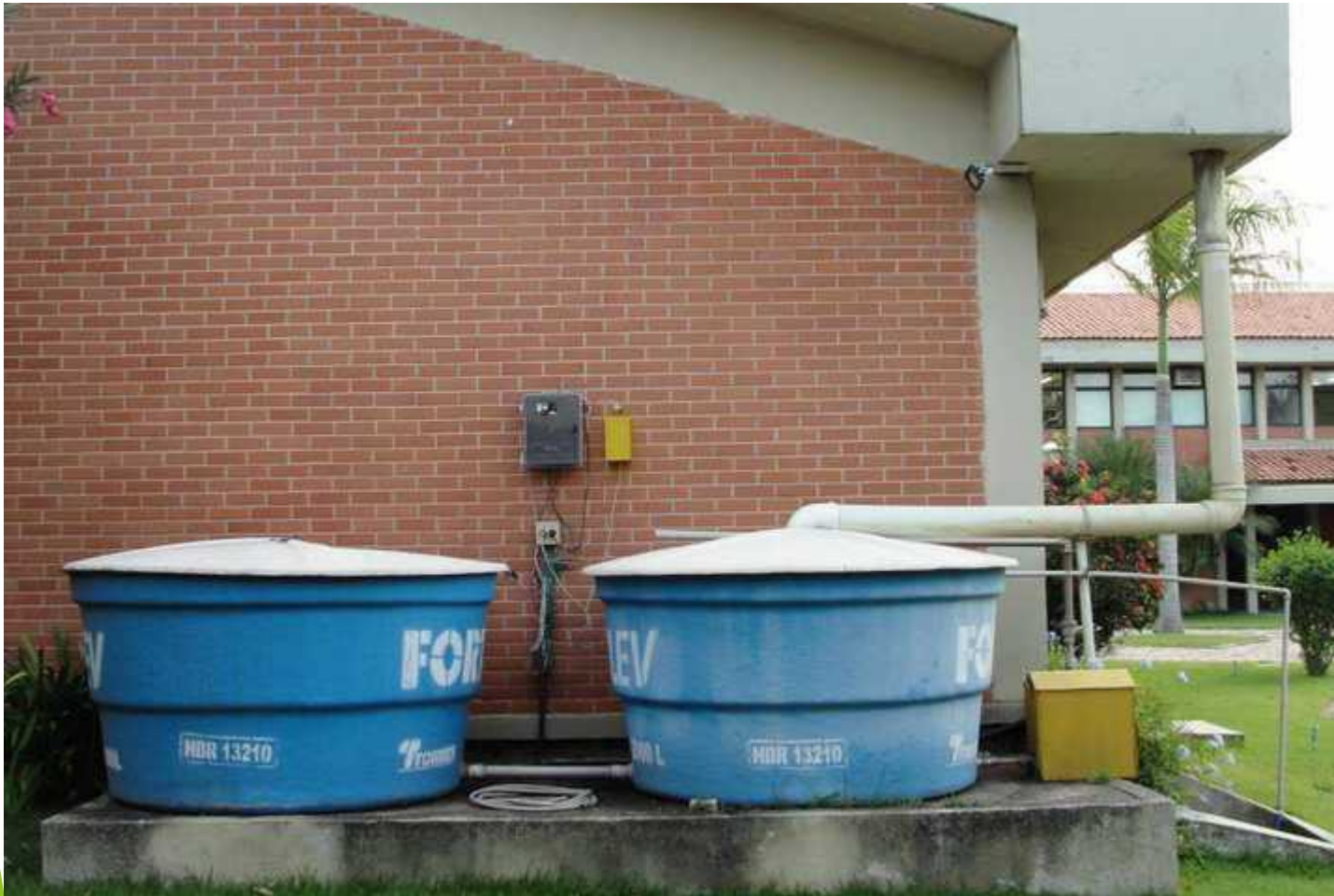
Captação de Água de Chuva
